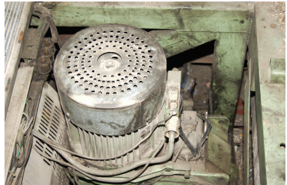
顶部站台凹槽里的自动扶梯电动机
